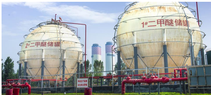
图：公司二甲醚储罐
